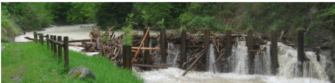
Herse de protection, sur le cours de la Veveyse - Photo © Bureau Stucky
